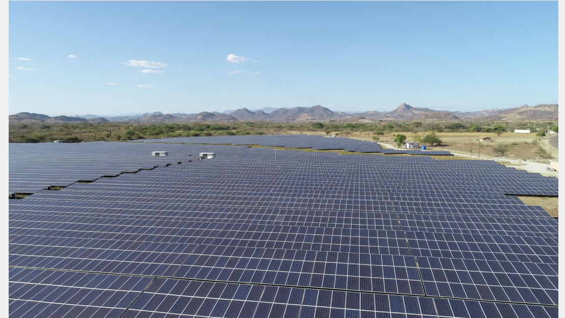
The 60 MW Agua Fria solar plant in Honduras.
