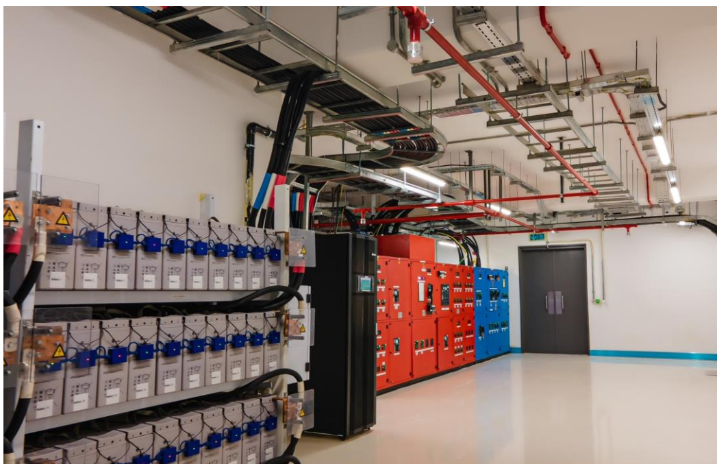
Salle technique n°2 du data centre
