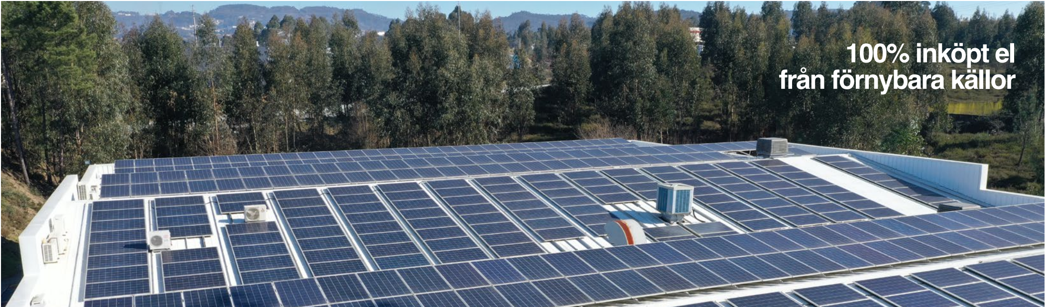
Nilörn Portugals fabrikstak är täckt med solpaneler
