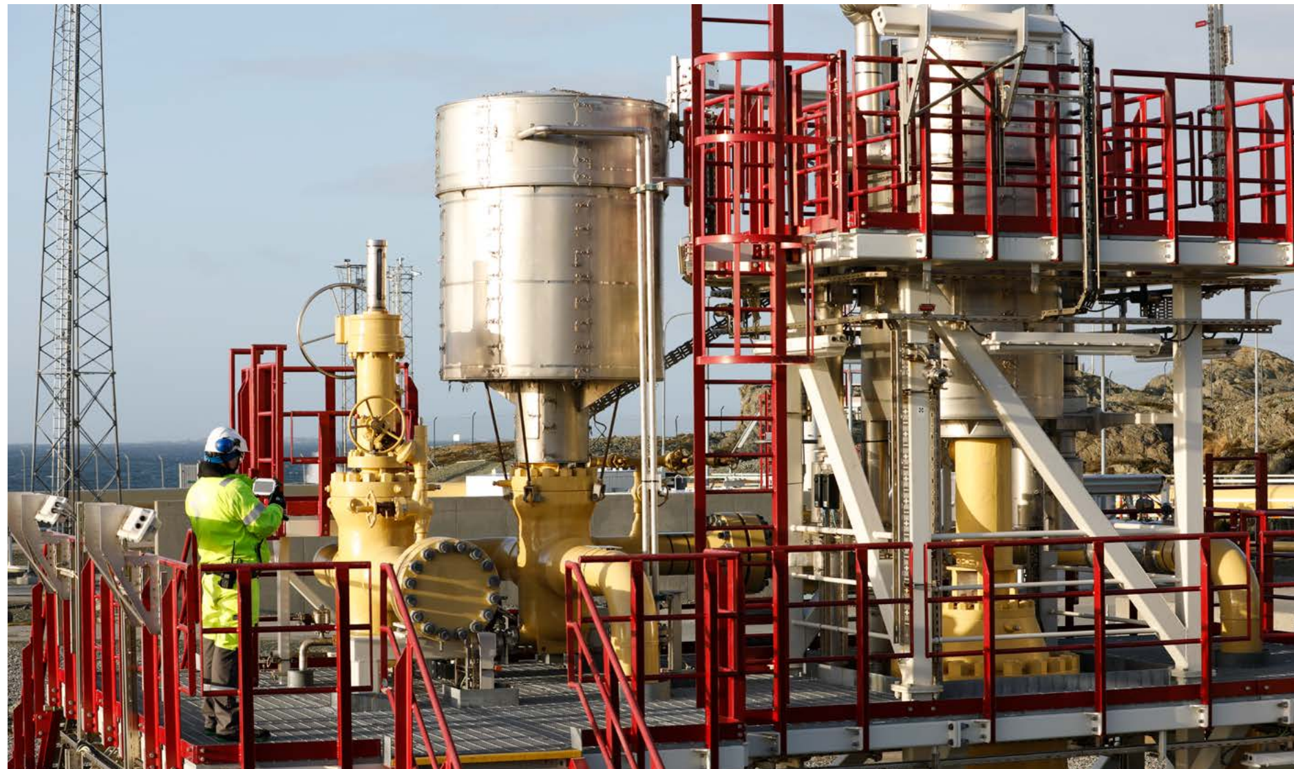
llandføringsanlegget på Kalstø, Rogaland.
