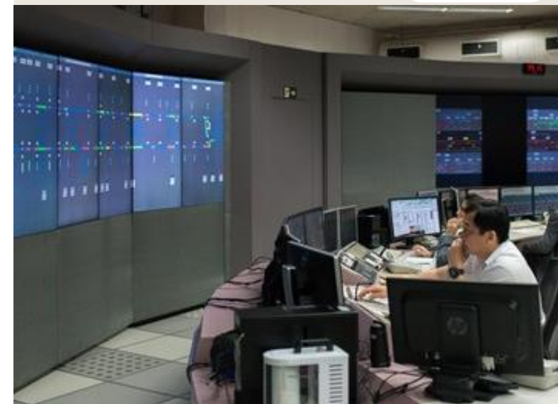
PERTH (SIGNALING - Australia)
