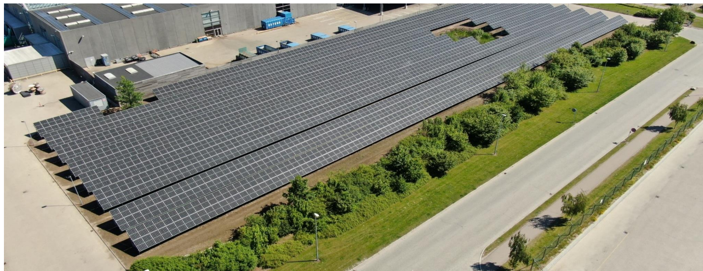
Solcellepaneler hos FK Distribution i Taastrup
