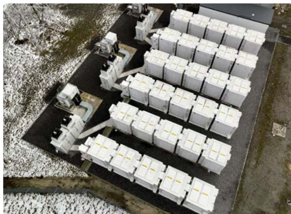
GreenStor • Het ESTOR-LUX batterijpark in Aubange
