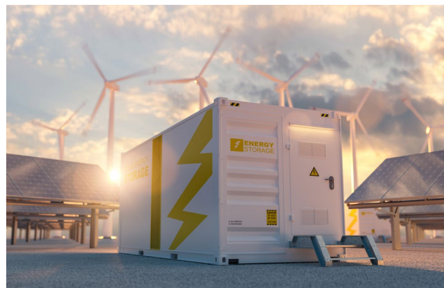
Anläggningar där vind- och solkraft kombineras med batterilagring kommer att bli vanligare.
