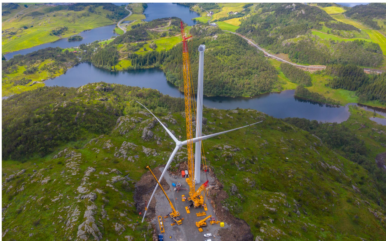
Eolus har ingen egen entreprenadverksamhet utan bolagets roll är att projektleda byggnationen och agera som beställare gentemot projektens entreprenad-, elnät- och turbin- eller solcellsleverantörer. Bilden är tagen i vindpark Stigafjellet i Norge.
