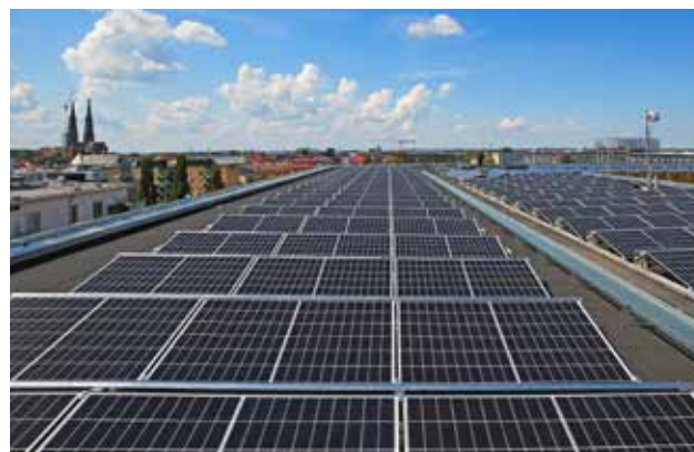
En av Klöverns 18 solcellsanläggningar finns på Uppsala Gate.
