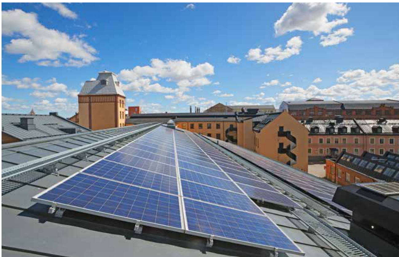
Solpaneler på fastigheten Kopparhammaren 2 i Norrköping. Under 2020 installerades totalt sex nya solcellsanläggningar på Klöverns fastigheter.
